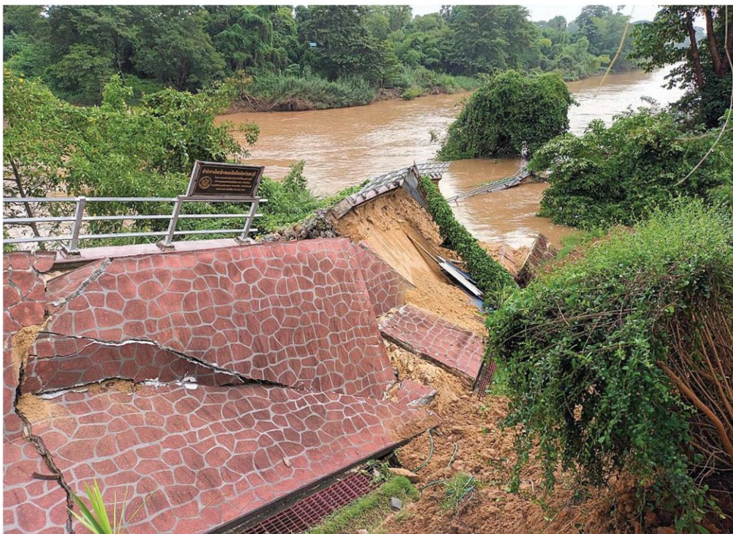
🏠 ตลิ่งถล่ม - สภาพเขื่อนป้องกันตลิ่งริมแม่น้ำป่าสัก บริเวณชุมชนวัดศรีบูรรัตนาราม (วัดเปรี้ยว) เขตเทศบาลเมืองสระบุรี จ.สระบุรี พังถล่มลงไปในลำน้ำ หลังระดับน้ำในแม่น้ำป่าสักเอ่อสูงขึ้น เมื่อวันที่ 27 ก.ย.
