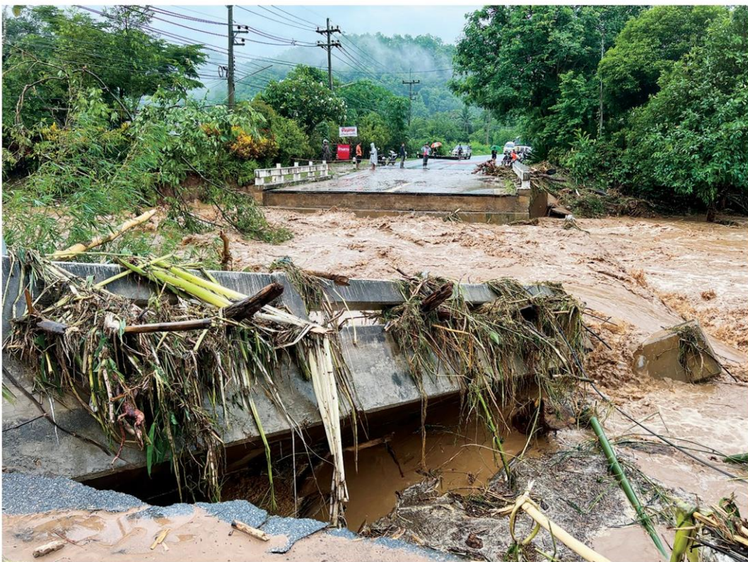
☞ ฤทธิ์น้ำป่า - สะพานข้ามลำห้วยแม่สะมาด บริเวณบ้านผาบ่อง อ.เมือง จ.แม่ฮ่องสอน ถูกน้ำป่าขัดขาดหลังเกิดพายุฝนถล่มอย่างหนักในพื้นที่ ทำให้เส้นทางสัญจรถนนสายแม่ฮ่องสอน-ขุนยวมถูกตัดขาด เมื่อวันที่ 1 ก.ค.
