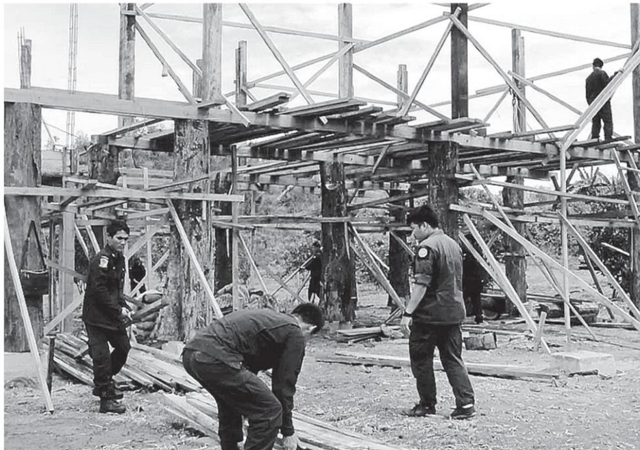
ยึดไม้สัก เจ้าหน้าที่สนธิกำลังเข้าตรวจยึดไม้สักปลูกสร้างบ้านอยู่ในป่าบ้านไร่หลวง ต.นาพูน อ.วังชัน จ.แพร่ หลังมีกลุ่มนายทุนจ้างคนงานตัดไม้ปลูกบ้านบังหน้าแล้วทยอยไปขาย.
